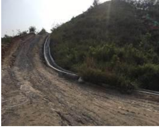
堆渣场区内排水沟
